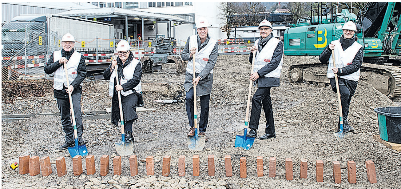
Landammann Stephan Attiger, die Untersiggenthaler Frau Gemeindeammann Marlène Koller, ABB-Vertreter Morten Wierod und Robert Itschner sowie Architekt Manuel Alberati beim Spatenstich.
