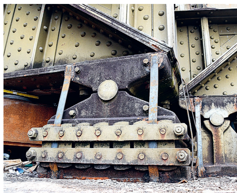
Auf diesen Lagern liegt der Brückenträger normalerweise auf dem Pfeiler, weil aber der Träger nun ein paar Millimeter höher liegt, hängt dieses Lager ganz leicht in der Luft und wird durch angeschweisste Flacheisen zusammengehalten.
