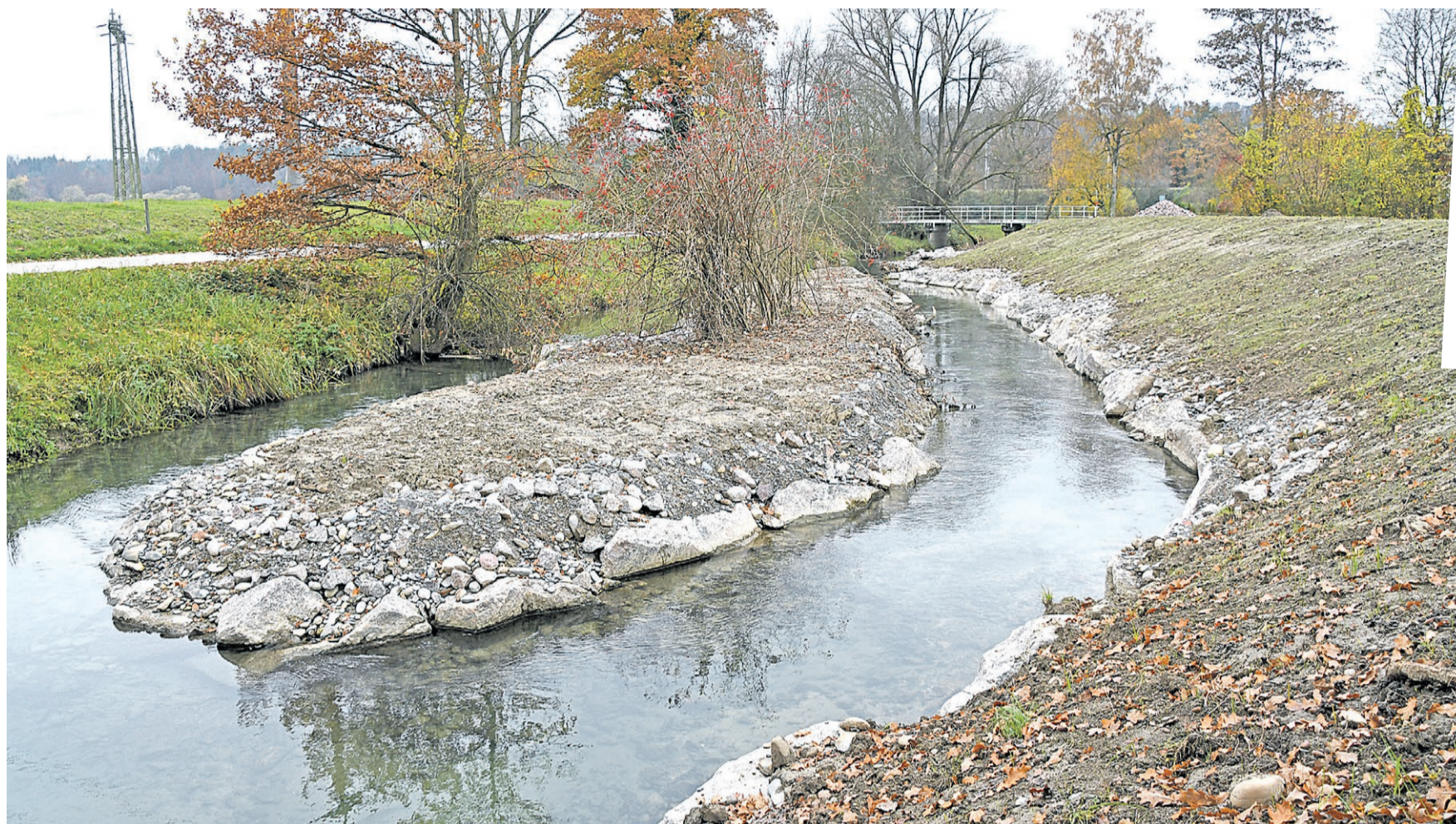
Eine von zahlreichen Massnahmen am Binnenkanal: Unterhalb des Kraftwerks Klingnau hat das Gewässer ein kleines Inseli erhalten.
