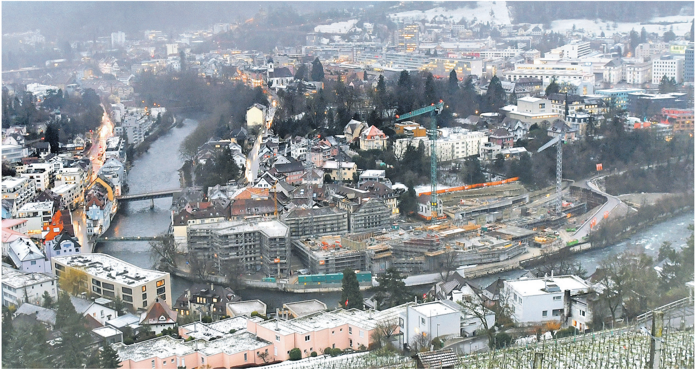
Blick auf die «neuen Bäder» von Baden: Das Ärzte- und Wohnhaus ist im Rohbau vollendet, das neue Thermalbad ist ebenfalls schon gut zu erkennen, das Verenaquartier dahinter ist inzwischen eingerüstet worden.
