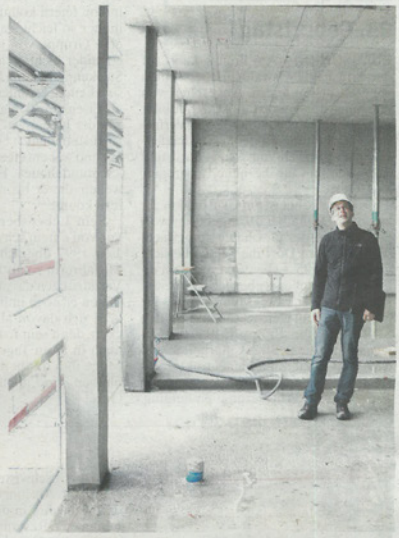
Bauverwalter Mirco Meier im ersten Stock, wo zwei Klassenzimmer einen gemeinsamen Aussenraum haben.
